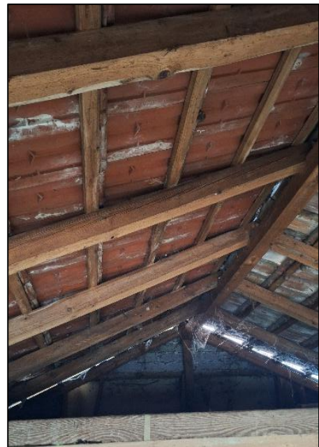
Abb. 13: Dachziegelspalten der Garage.
