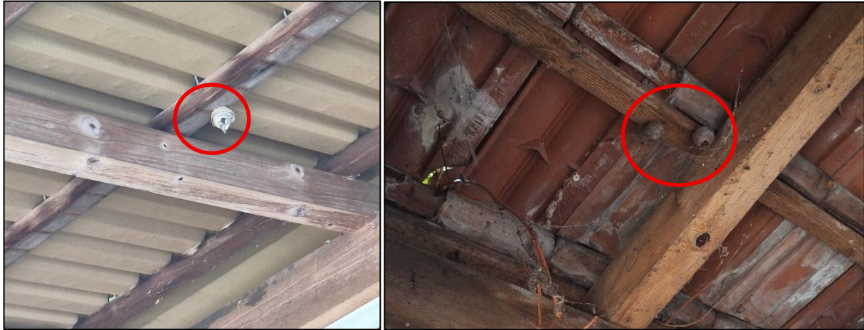
Abb. 15: Wespenester auf der inneren Dachfläche der Garage (linkes Bild) sowie der offenen Scheune (rechtes Bild).
