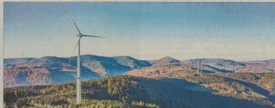
Auf dem Hohenlochen wird zur Zeit ein Windpark errichtet. Vier Windräder sollen dort Energie gewinnen. Archivfoto: Andreas Walny
